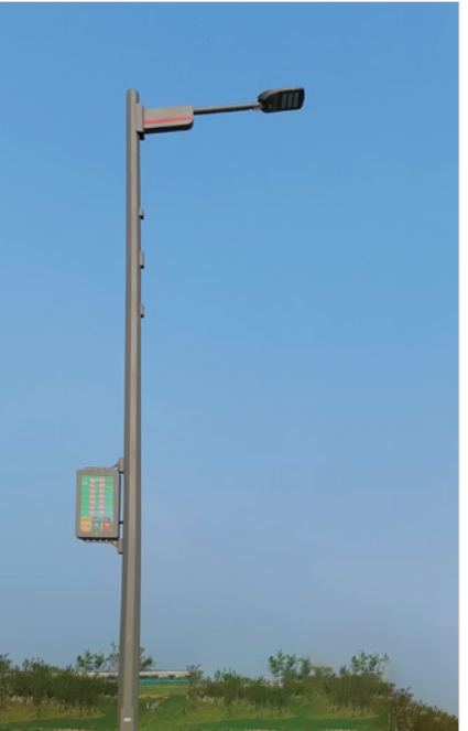
现代简约系列/致敬 致敬英雄,致敬城市 智慧照明 / 智慧安防 / 公共广播 公共WiFi / 智慧感知 / 智慧环境 情景氛围 / 应急求助 / 信息发布 汽车充电 / 手机充电 / 5G微基站
